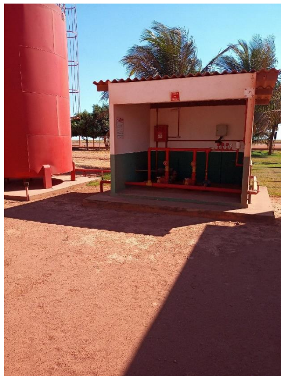
Figura 9: Casa de bomba.
